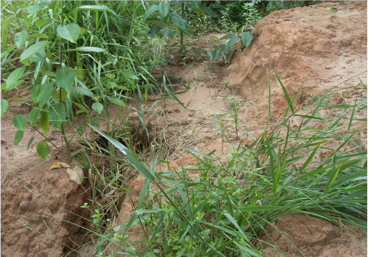
Figura 11 Erosivo de ravina na trilha da rede de água pluvial do Jardim Itália - Autor: Paulo J. Scapin
