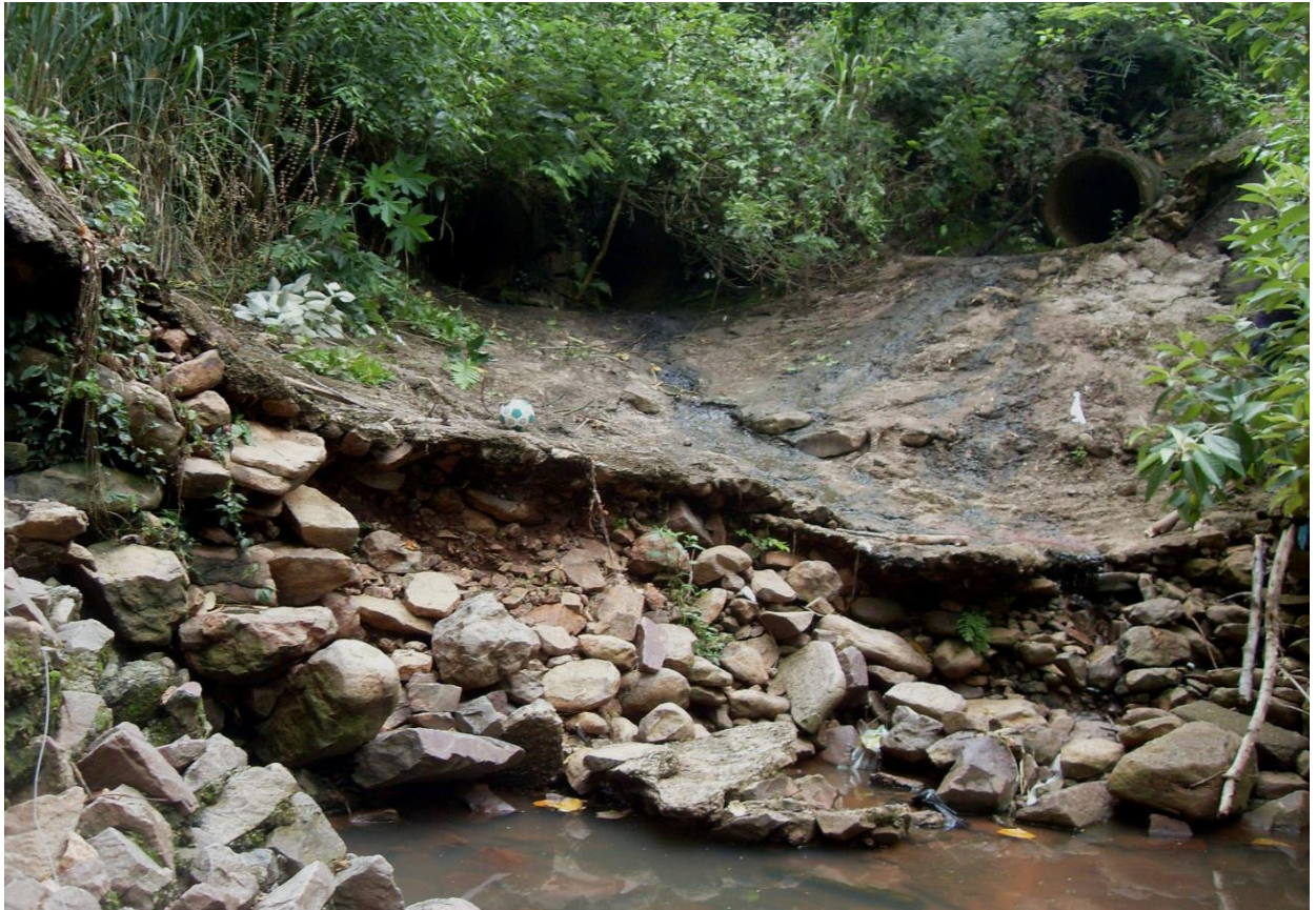
Figura 20 - Galerias de águas pluviais sem emissários no córrego Fantasmilha - Autor: Paulo J. Scapin
