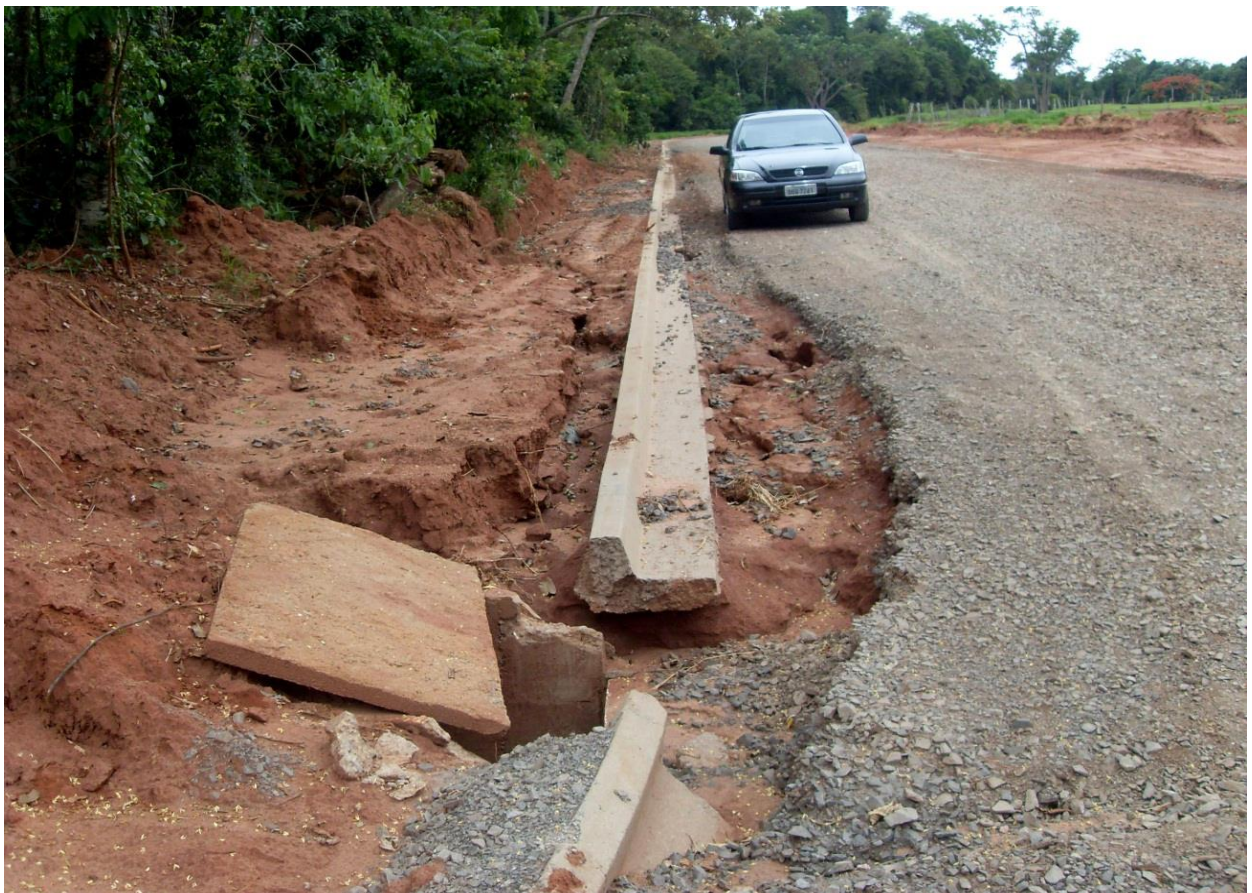
Figura 10 – Erosão de sulcos causada pela pavimentação alfáltica no Parque do Bosque - Autor: Paulo J. Scapin
